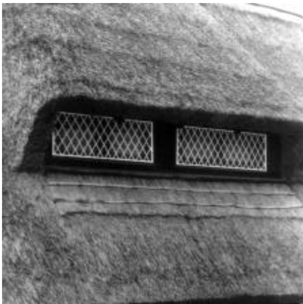
Balaton-felvidéki átépítésnél alkalmazott tetőablak. Műszakilag korrekt, de a vagyonsvédelem miatti rácsozás idegen a nádfedések - től.
